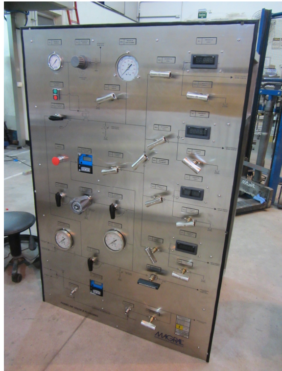
PAINEL DE FLUSHING
